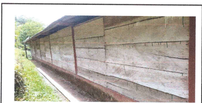
Foto 3: Pared de madera ya deteriorado. Se sustitua por hiladas de block y cimientos.
